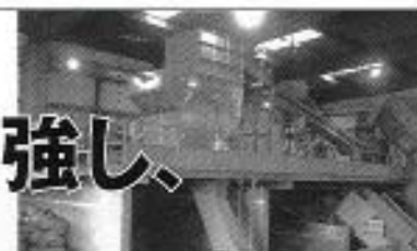
燃料選別ラインの輸送設備
